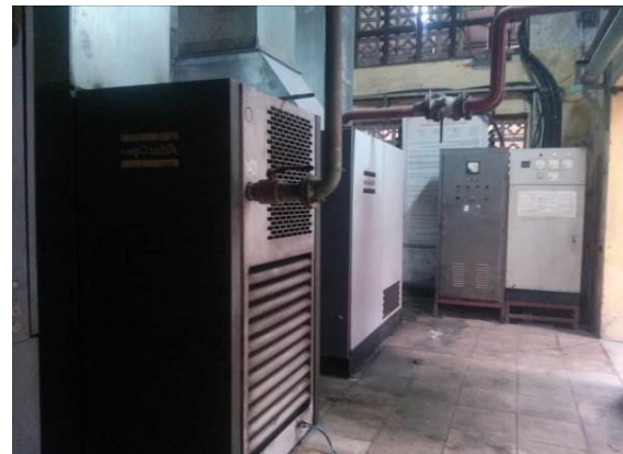
Thiết bị máy nén tại trạm khí nén số 1
