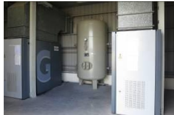
Hình ảnh trạm khí nén
