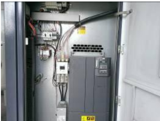
Biến tần Siemens cho máy nén khí
