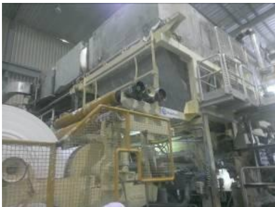
Dây chuyền sử dụng hơi nước áp suất 10 bar
