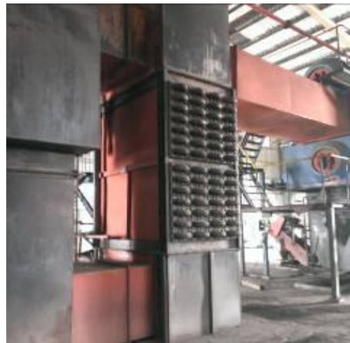
Hình ảnh lò hơi được trang bị bộ hâm nước
