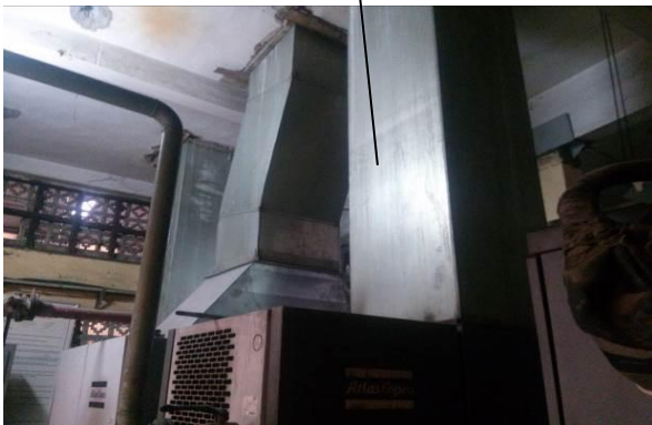
Đường dẫn gió nóng từ các máy nén khí ra ngoài trạm khí nén
