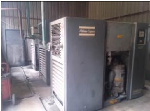
Thiết bị máy nén tại trạm khí nén số 2
