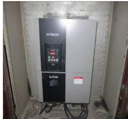
Thiết bị biến tần lắp cho máy nén khí
